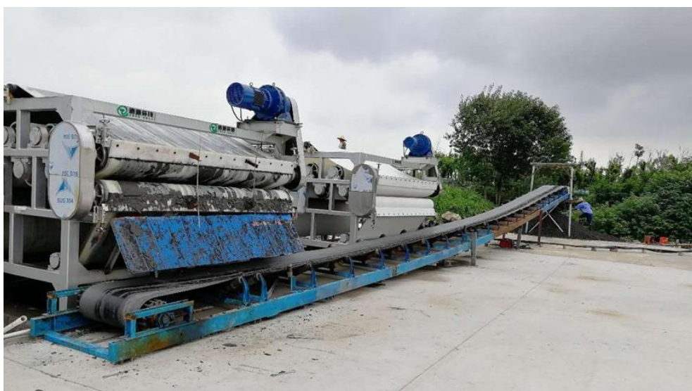
图 5.2- 4 污泥脱水干化机现场
