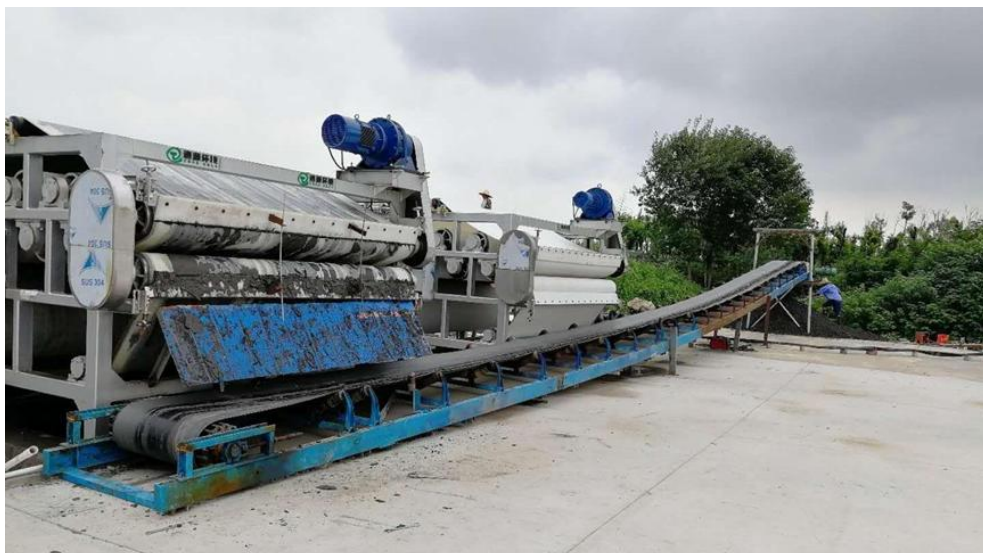
图 5.2- 4 污泥脱水干化机现场
